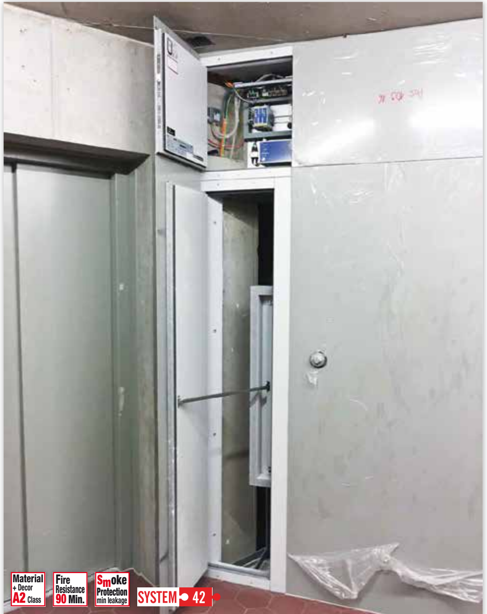
Entrauchungsklappe PRIODOOR ETX RDA, oberhalb Revisionstür PRIODOOR ETX, kundenseitig aufgebrachte Edelstahloberfläche
