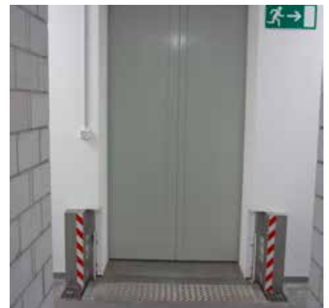
Gefahrenutlager Landi Reba, Aesch
