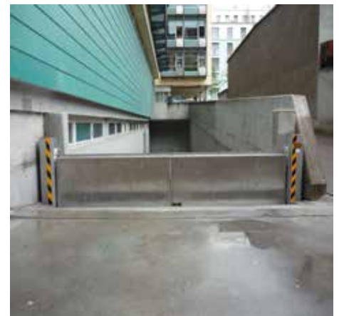
Tiefgaragen-Klappschott Heinrichstrasse 216, Zürich
