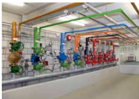
Sprinkler- und Sprühflut-Demoanlage Quelle: JOMOS, Balsthal
