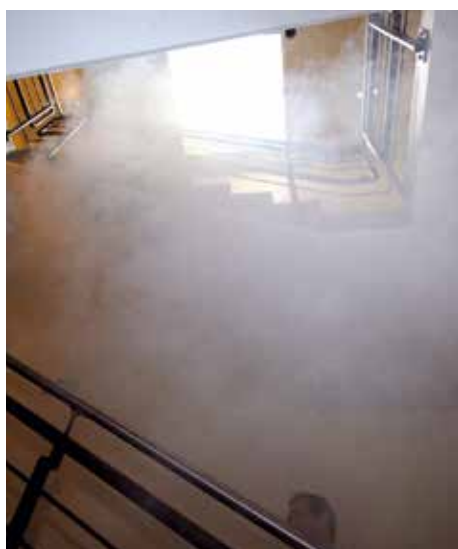
Visualisierung der Entrauchungsfunktion Prüfung der Abström-, Zuluft- und Abluft-Öffnungen
