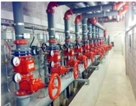
Nasssprinkleranlage Quelle: JOMOS Balsthal
