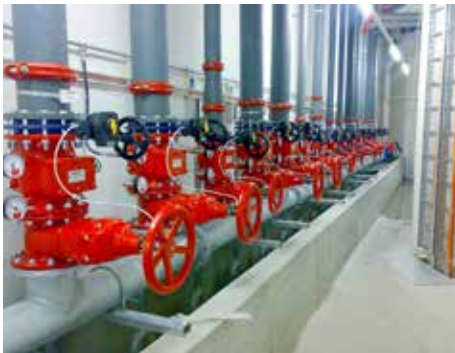
Nasssprinkleranlage Quelle: JOMOS Balsthal
