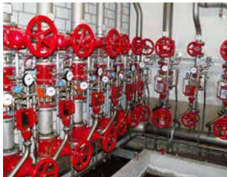
Sprühflutanlage Inbal Quelle: JOMOS Balsthal
