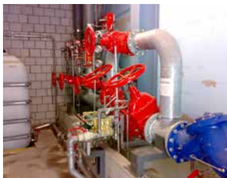
Trockensprinkleranlage Inbal mit Schaumzumischung Quelle: JOMOS Balsthal
