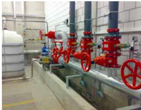
Nasssprinkleranlage mit Schaumzumischung Quelle: JOMOS Balsthal
