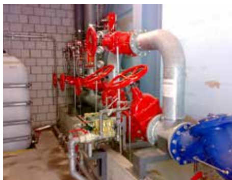
Installation sprinkler sèche Inbal avec adjonction de mousse Source : JOMOS, Balsthal
