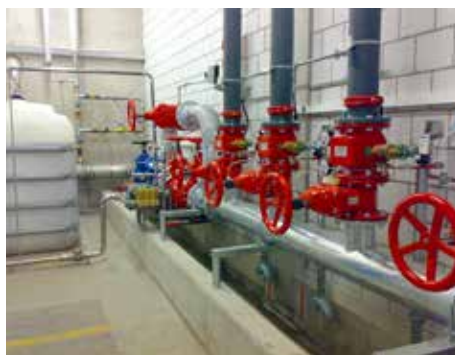
Installation sprinkler humide avec adjonction de mousse Source : JOMOS, Balsthal
