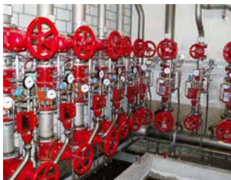
Installation déluge Inbal Source : JOMOS, Balsthal
